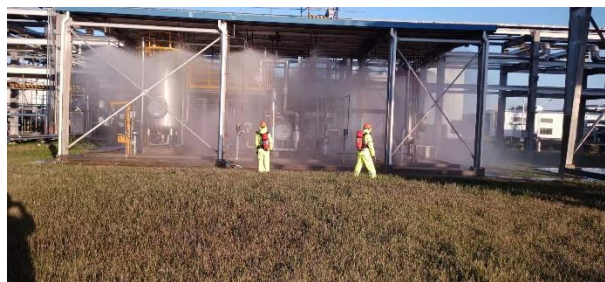
消防喷淋启动
