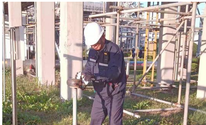
事故废水阀门切换
